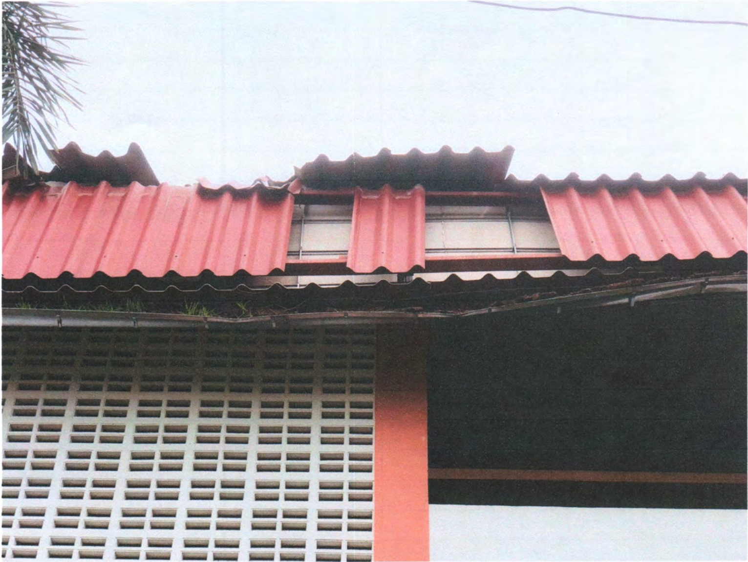
อาคารเรียนที่เสียหายจากวาตภัย โรงเรียนบ้านหนองแอก
